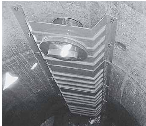
● 2号マンホール
