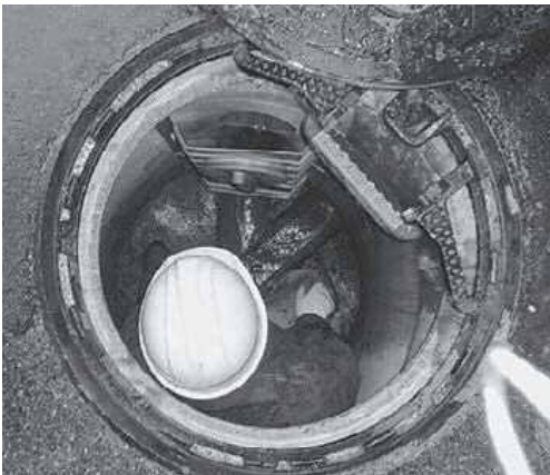
● 1号マンホール
