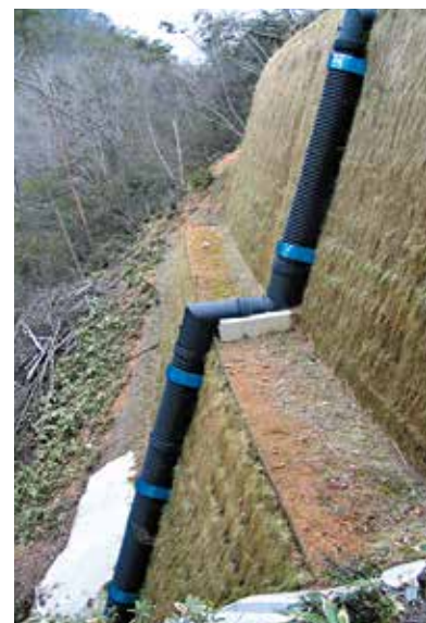
急傾斜露出配管
