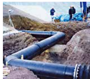
廃棄物処分場浸出水導水管
