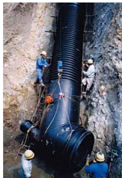
水力発電施設からの放流管
