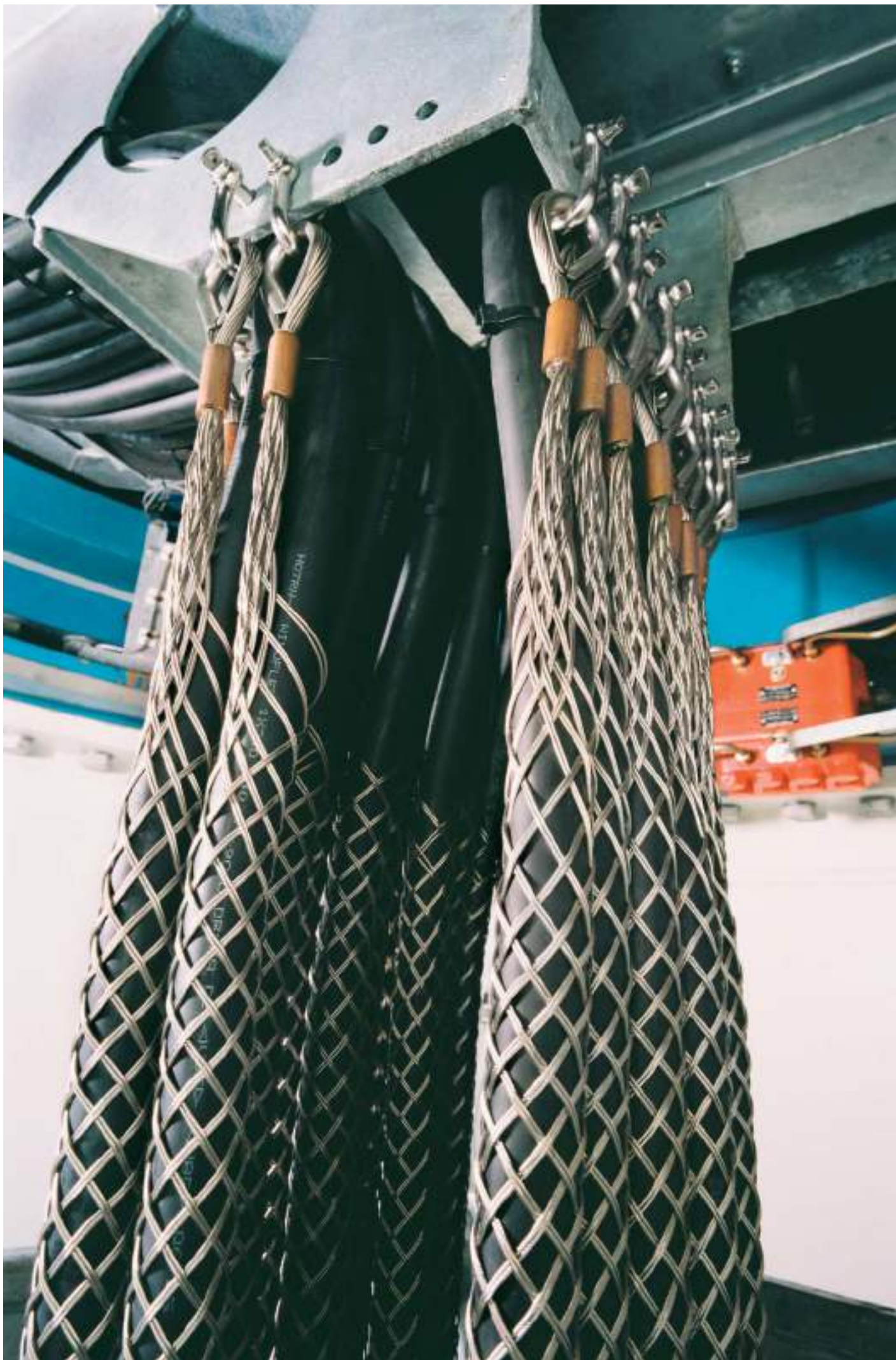
Zugentlastung der Energiekabel - Nordex N 90
