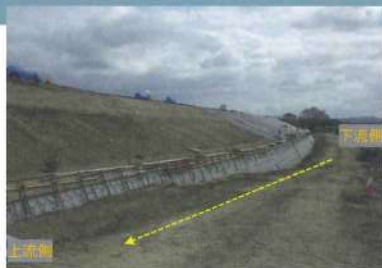
シートは下流側から上流側堤防天端から法尻方向へ展開する
