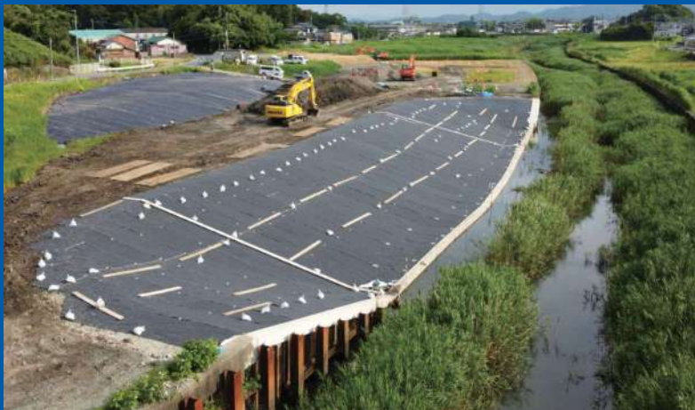
国土交通省九州地方整備局 遠賀川河川事務所 令和2年度岩崎地区矢板護岸補修工事
