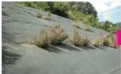
防草シートの隙間から雑草が伸び放題!!
