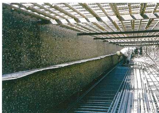
土木：浄水場での使用例
