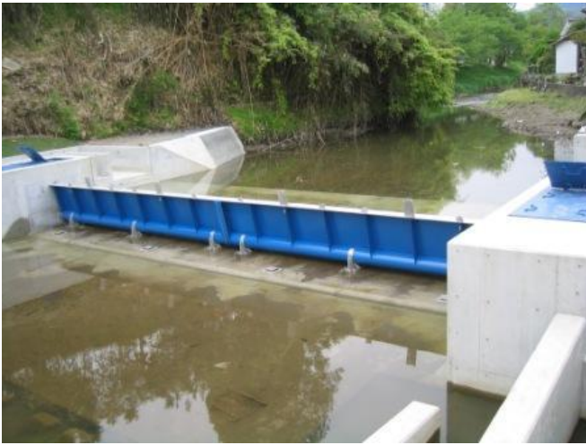
起伏ゲート開閉装置(熊本県)
