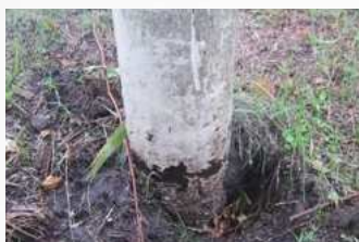
倒壊の原因となる腐食(錆)
